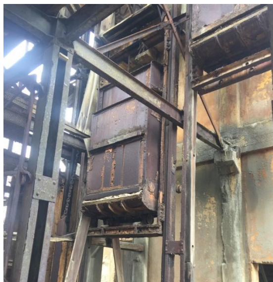
Fig. 1 – Alteración del material usado en el ascensor de bajada en mina de sulfuros.
